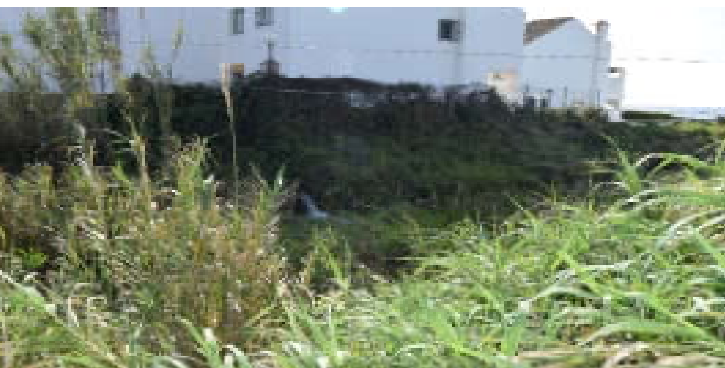
Vertidos de aguas residuales sin depurar a cauce público.
